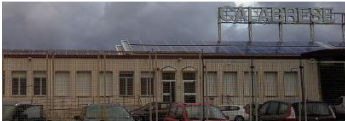
Modugno (BA) Azienda Calabrese, impianto fotovoltaico su copertura a shed
