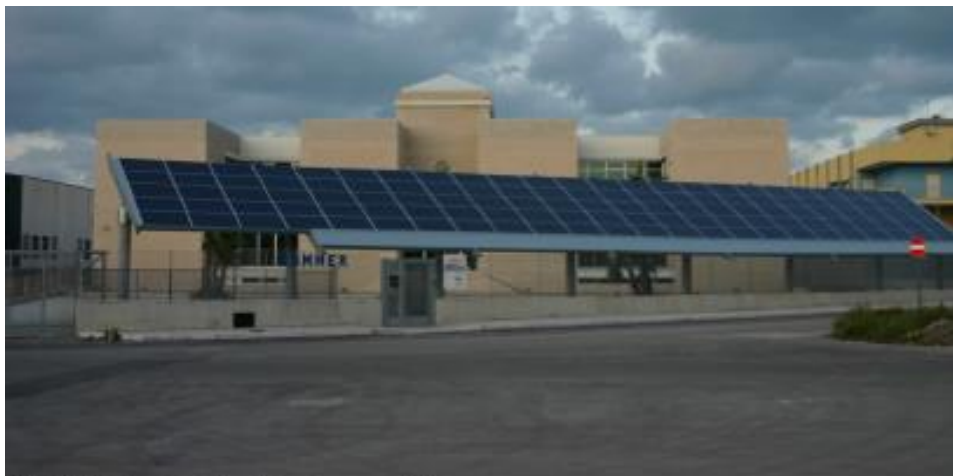
Molfetta (BA) pensilina fotovoltaica in zona produttiva
